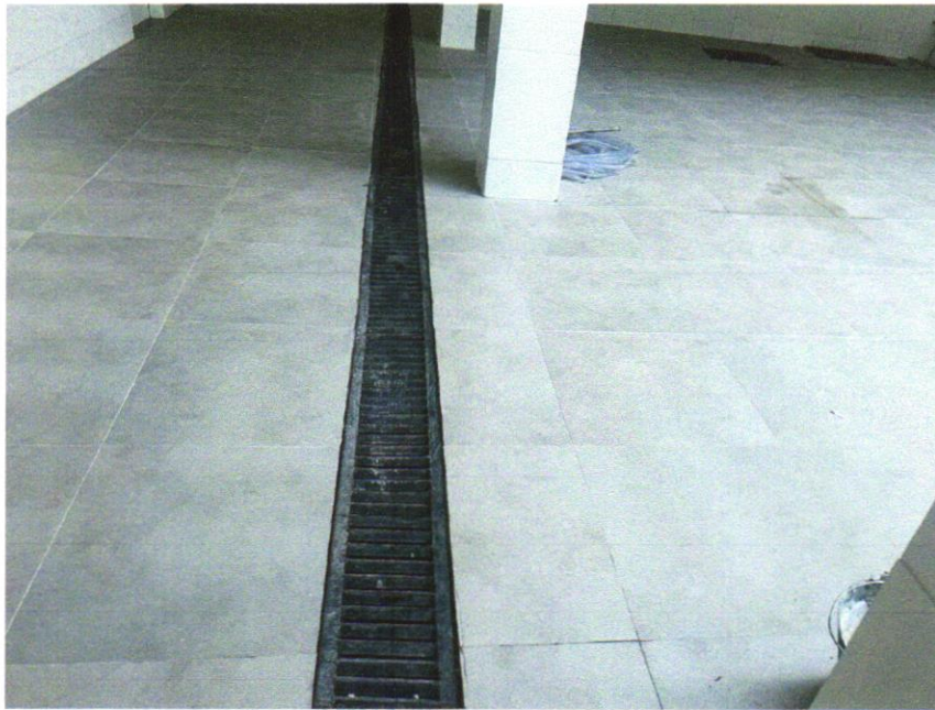
Foto 43 - GRELHA DE FERRO FUNDIDO SIMPLES COM REQUADRO, 200 X 1000 MM, ASSENTADA COM ARGAMASSA 1 : 3 CIMENTO: AREIA - FORNECIMENTO E INSTALAÇÃO. AF_08/2021
