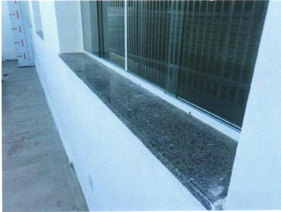
Foto 03 - PEITORIL LINEAR EM GRANITO OU MÁRMORE, L = 15CM, COMPRIMENTO DE ATÉ 2M, ASSENTADO COM ARGAMASSA 1:6 COM ADITIVO. AF_11/2020
