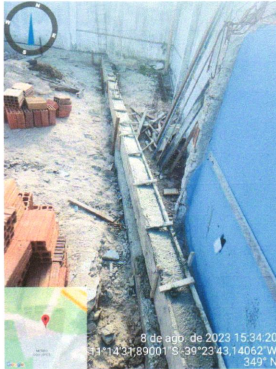
Foto 25 - (COMPOSIÇÃO REPRESENTATIVA) EXECUÇÃO DE ESTRUTURAS DE CONCRETO ARMADO, PARA EDIFICAÇÃO INSTITUCIONAL TÉRREA, FCK = 25 MPA. AF_01/2017
